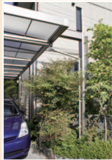
【敷地対応力②梁を飛ばす】 梁を延長して柱を植え込みに逃がしているの、邪魔にならず、車の出し入れもラクラク。
